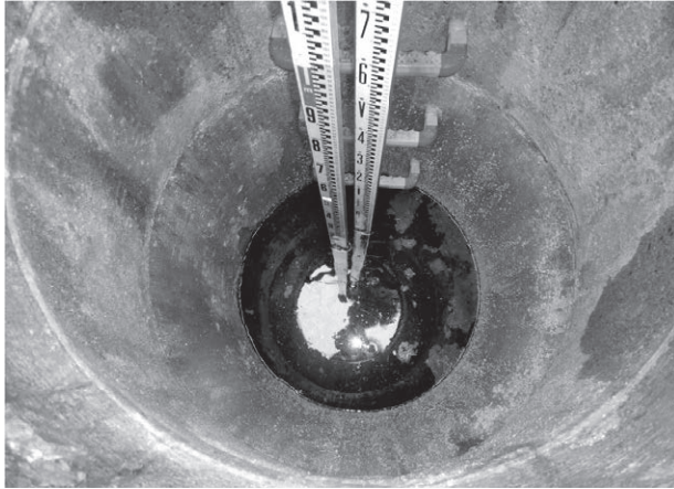
地震によるマンホール内の影響
