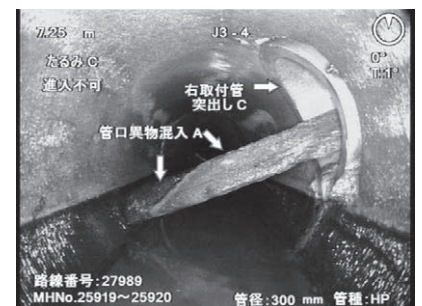
管口からの異物混入
