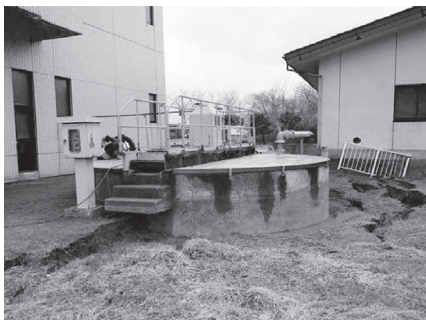
写真—1 地盤沈下により施設が剥離 (羽咋浄化センター)
