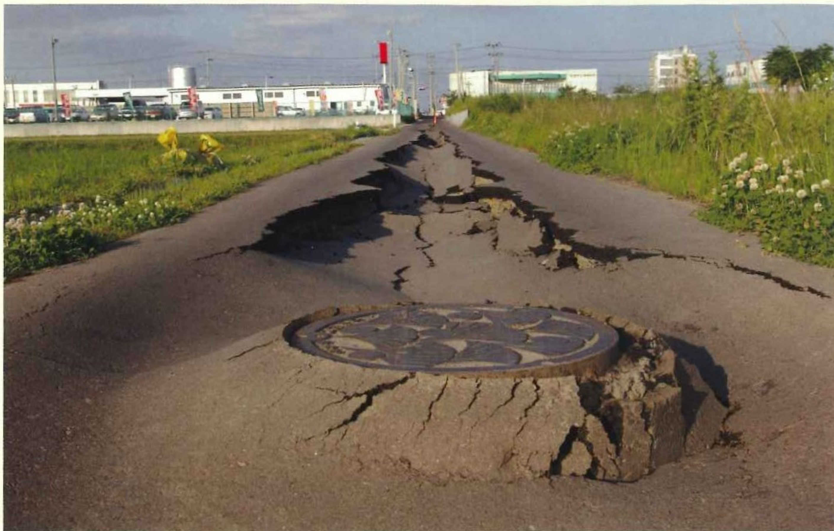
約250mにわたって陥没した道路。マンホールも浮上した
