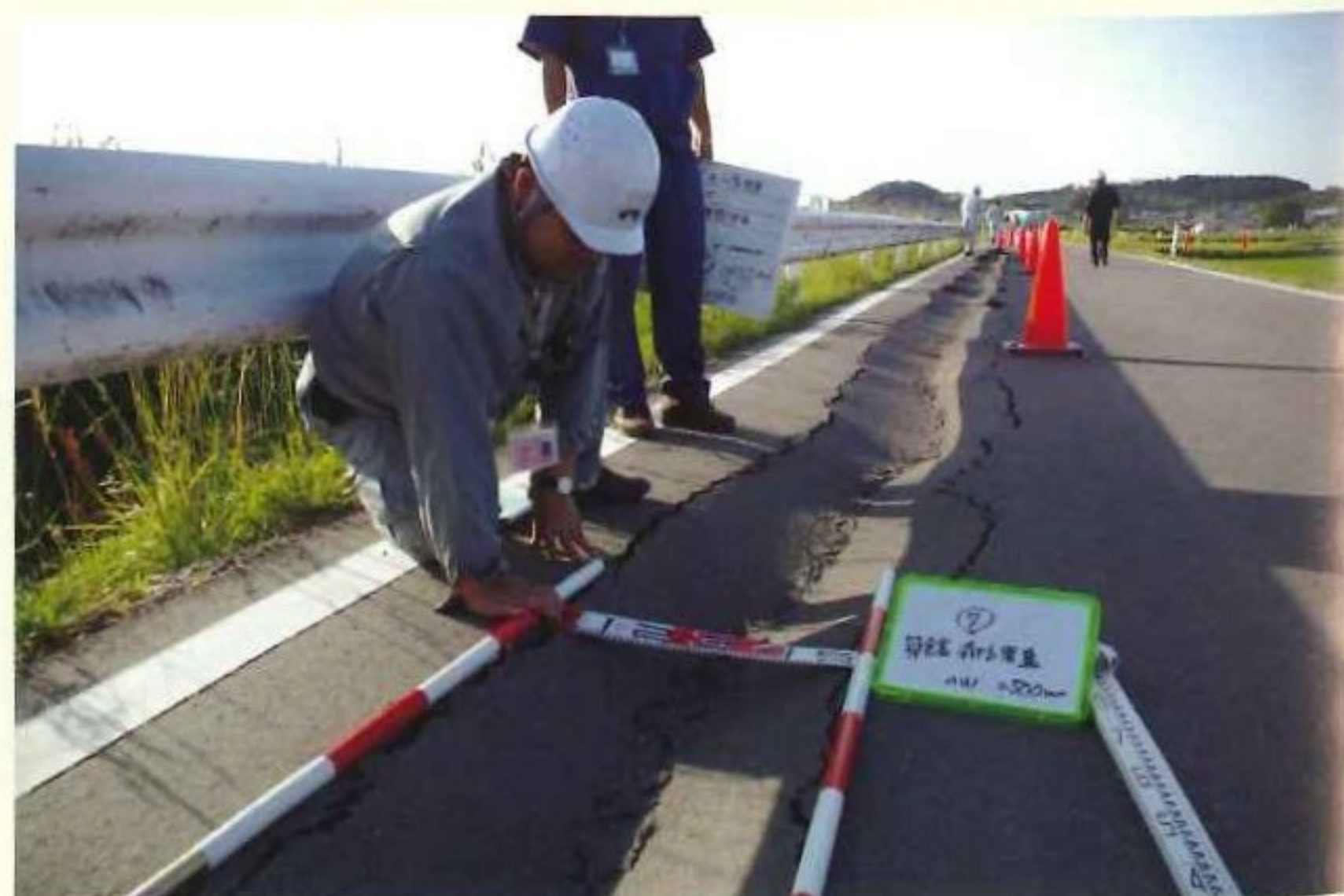
国土技術政策総合研究所、下水道新技術推進機構などの合同調査隊による調査が進んだ
