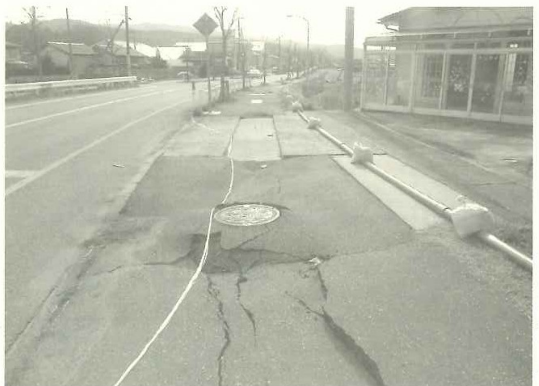
写真-2 下水道管に起因する歩道の陥没（門前地区）
