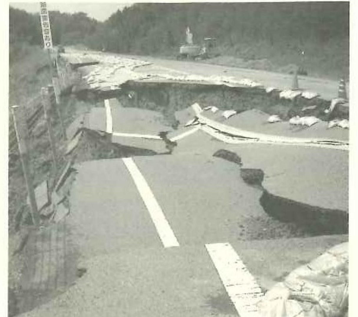
写真-5 地震により崩壊した能登有料道路
