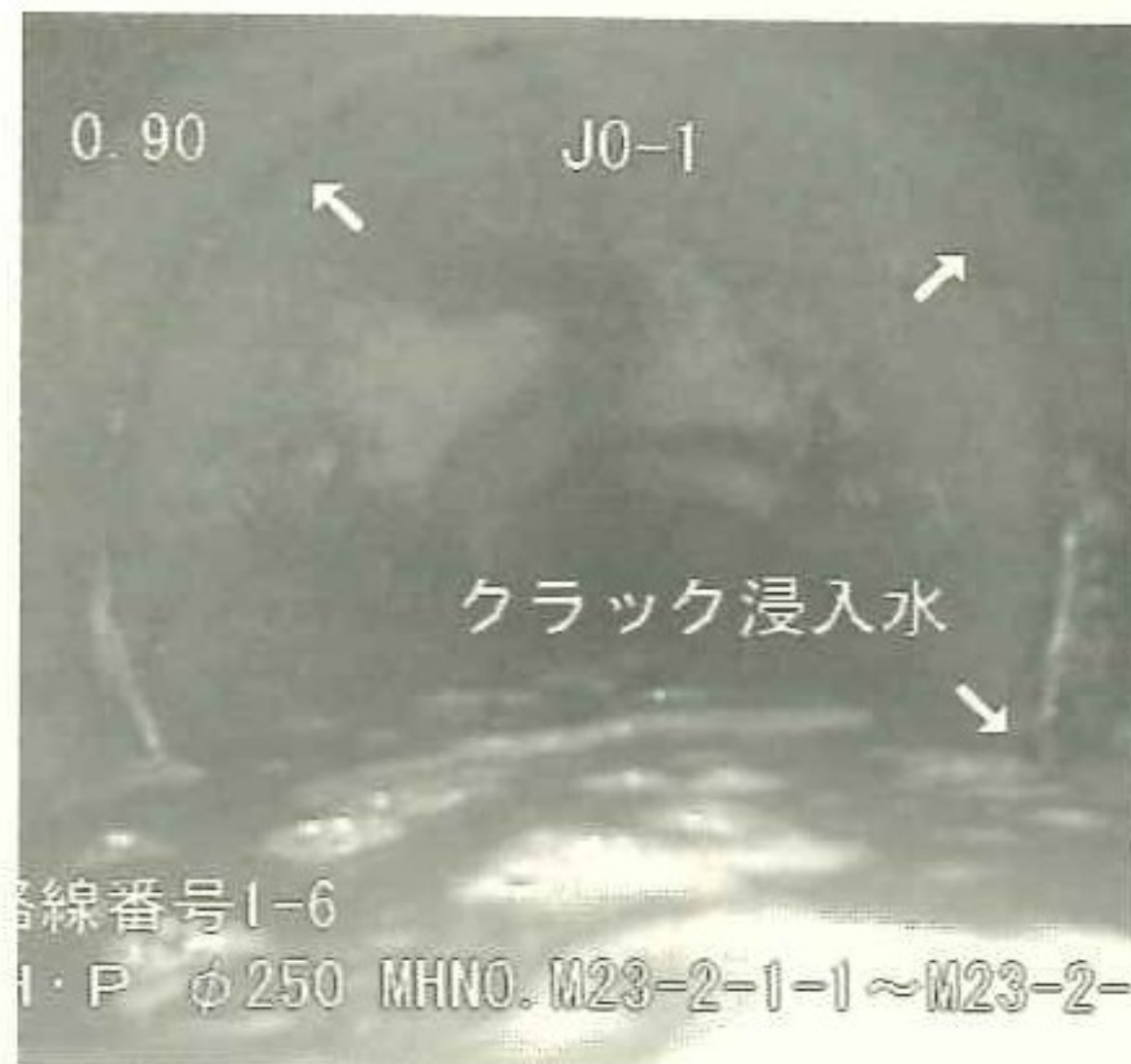
写真-4 クラックが発生し浸入水が管内に（門前地区）
