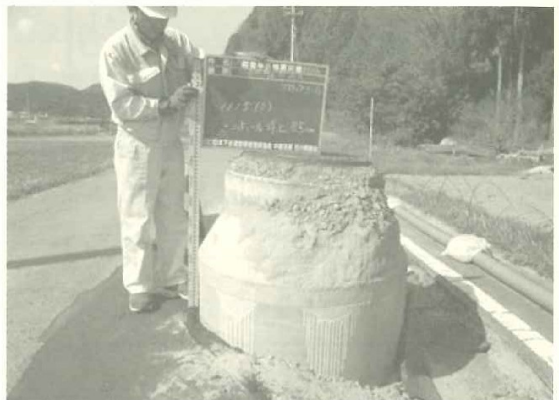
写真-1 液状化現象で浮上したマンホール（門前地区）
