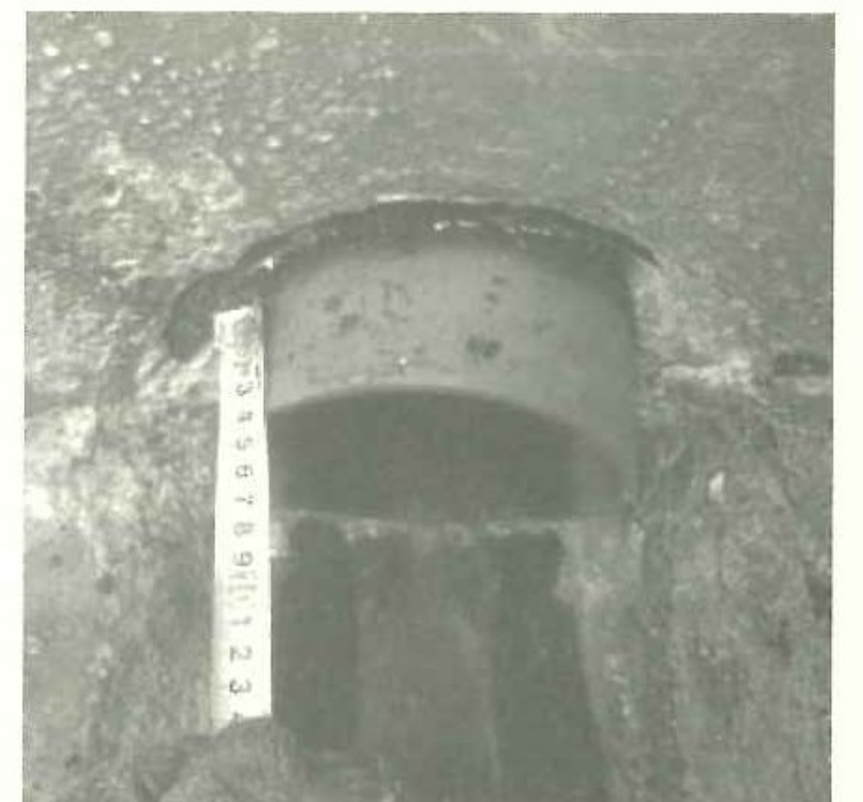
写真-8 地震動によって突き出した管渠（志賀町）
