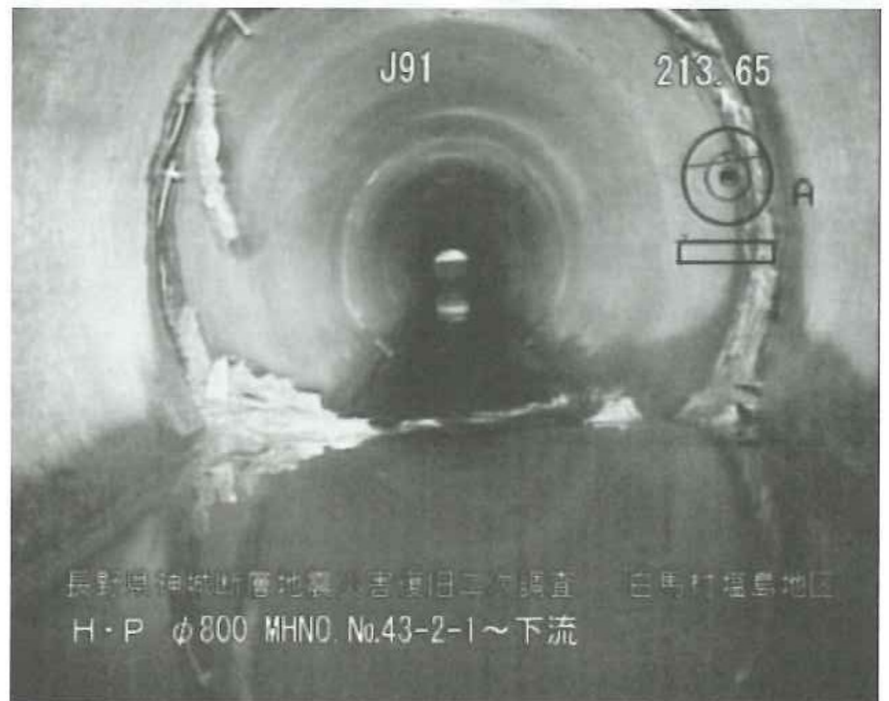
写真-4 破損状況
