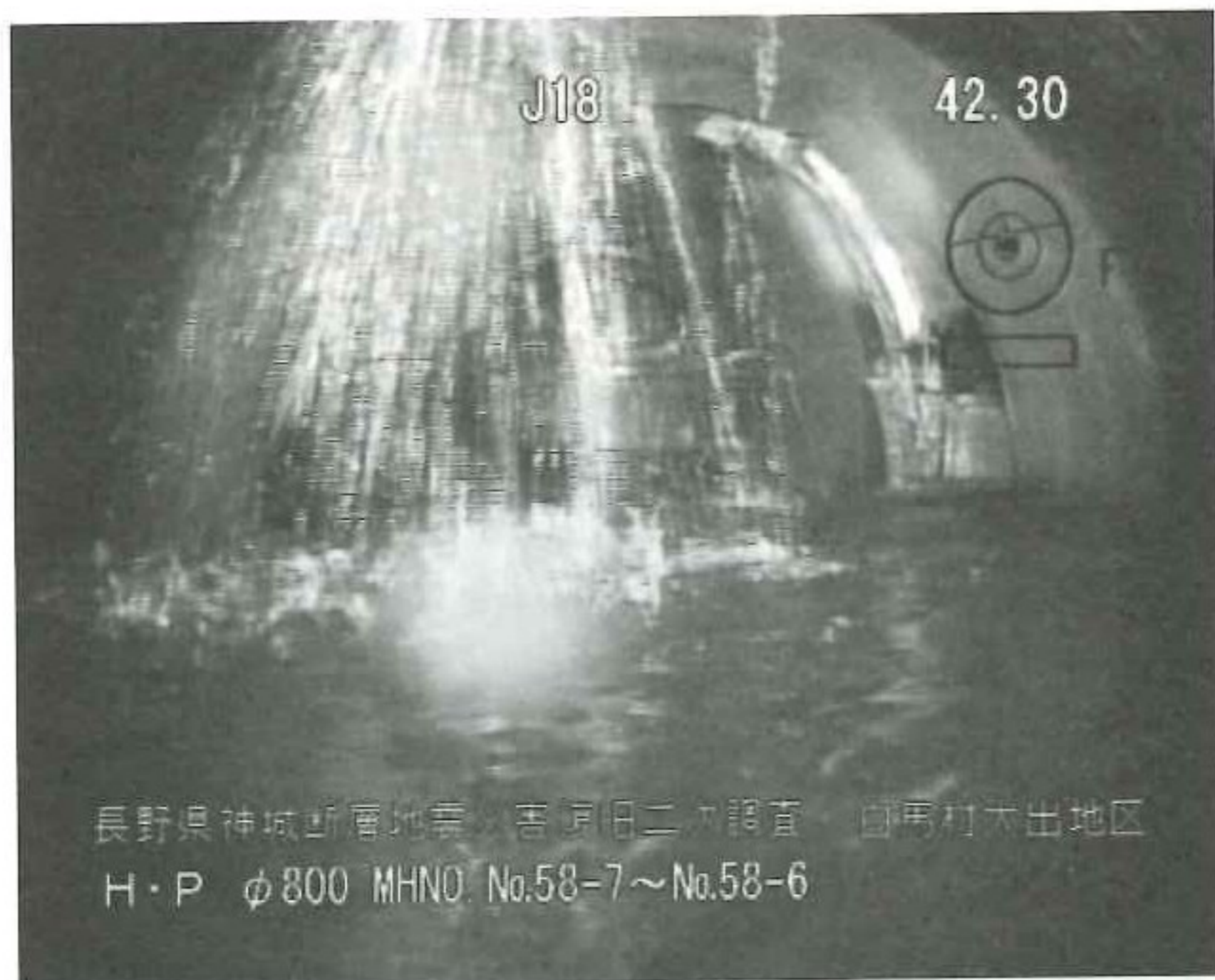
写真-7 取付管からの浸入水
