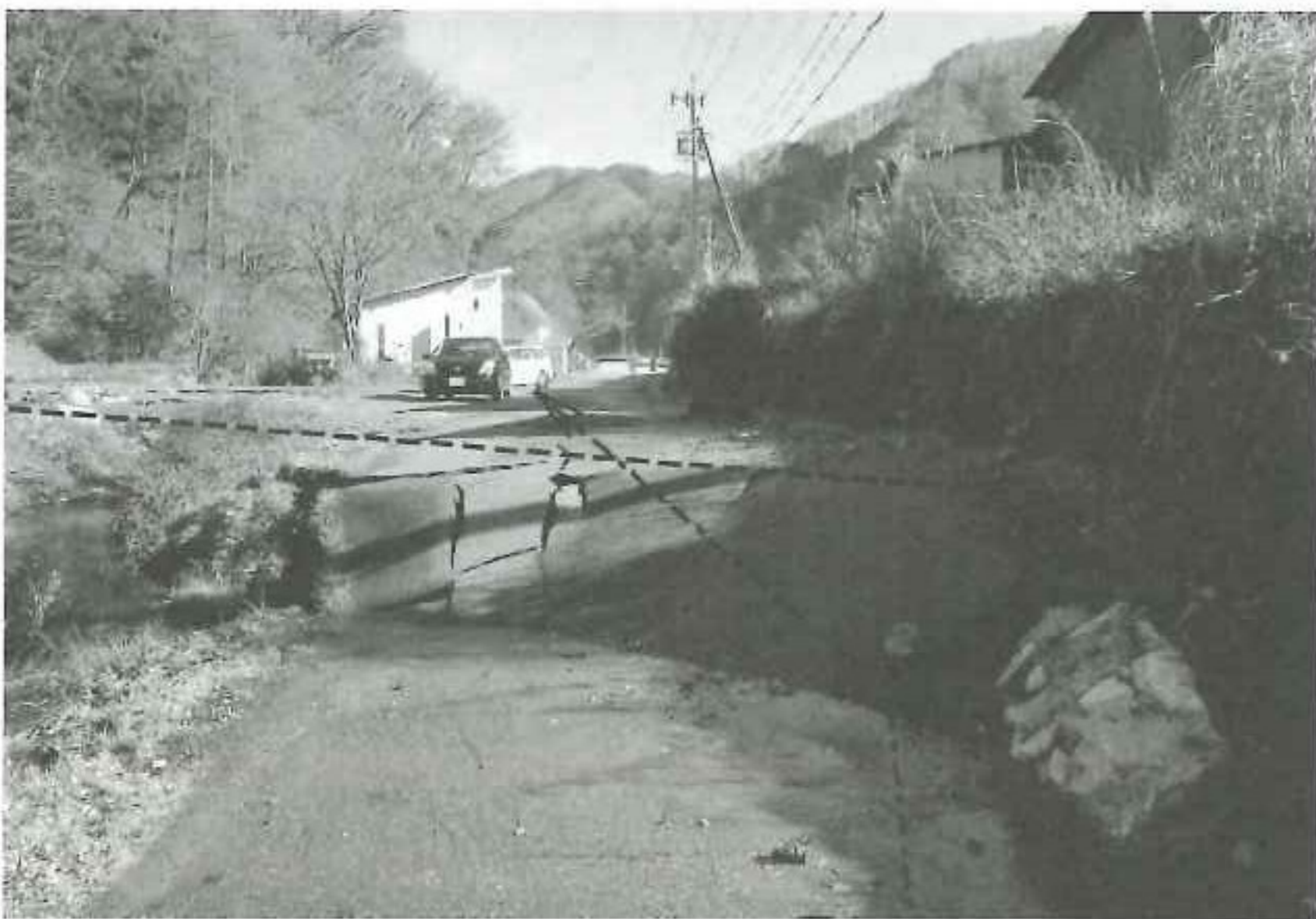
写真-2 段差の発生 破線：段差 一点鎖線：下水管路(以下同様)
