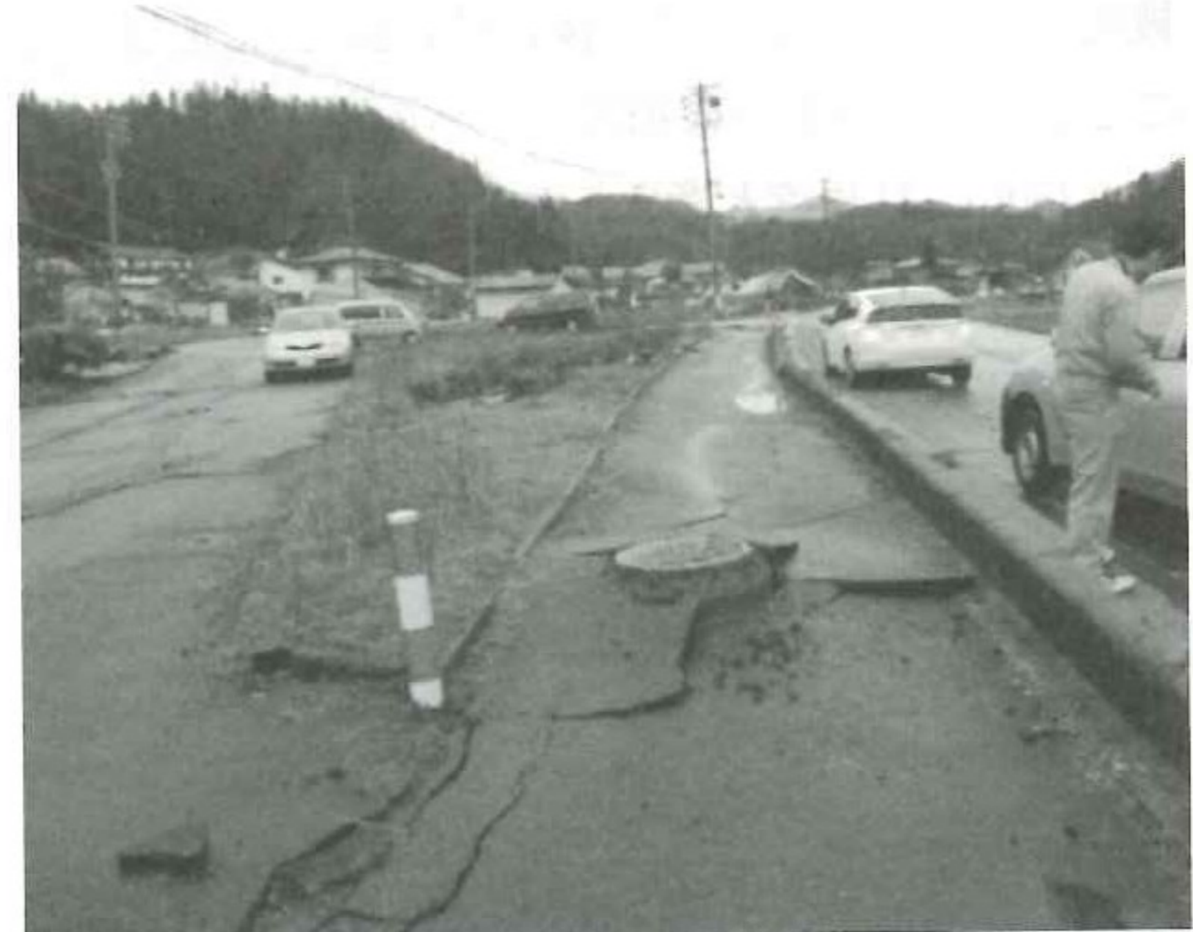
写真-9 マンホールの突出
