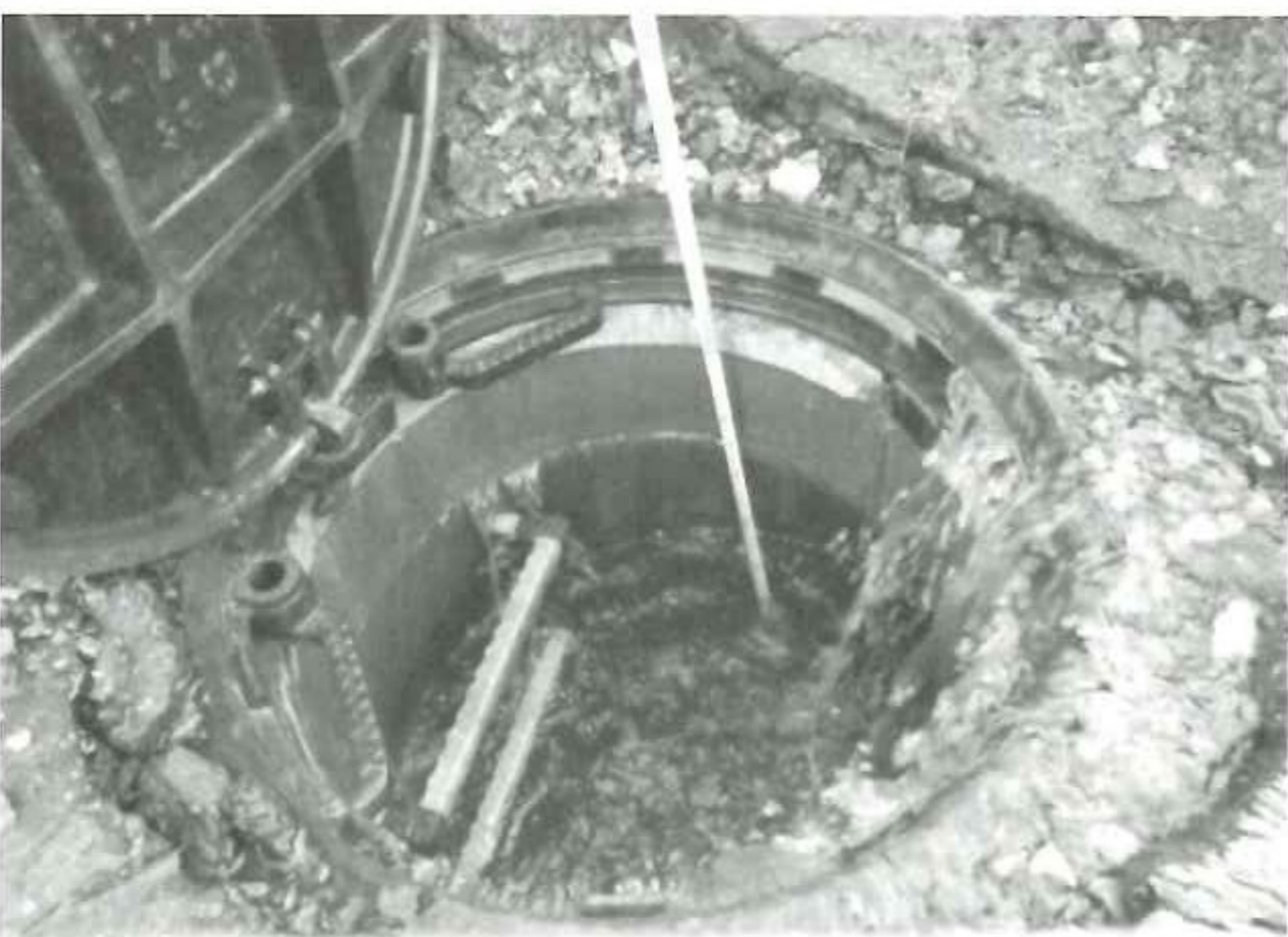
写真-3 段差付近のマンホールへの浸水
